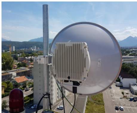
Pont FH SIAE 1 Gbps Full Duplex installé chez Caterpillar France
